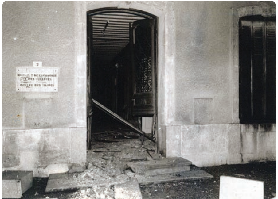
La porte du centre des impôts a volé en éclat tout comme la marche en béton.
